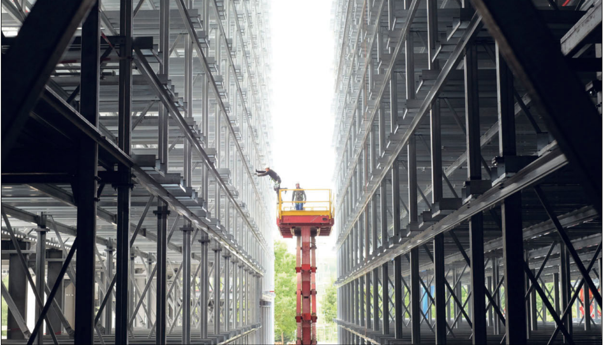
Inmitten des riesigen Hochregallagers wirken die Menschen so klein wie Spielzeug. Ein Arbeiter springt von einer Hebebühne auf die Stahlkonstruktion.
