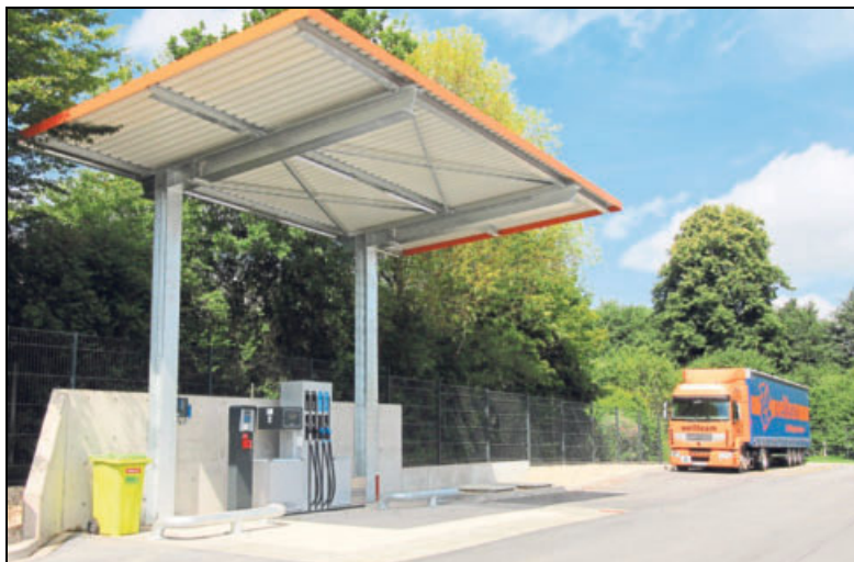
Unterirdische Tankbehälter für 90 000 Liter Diesel wurden an der neuen Tankstelle auf dem Wellteam-Areal installiert.
